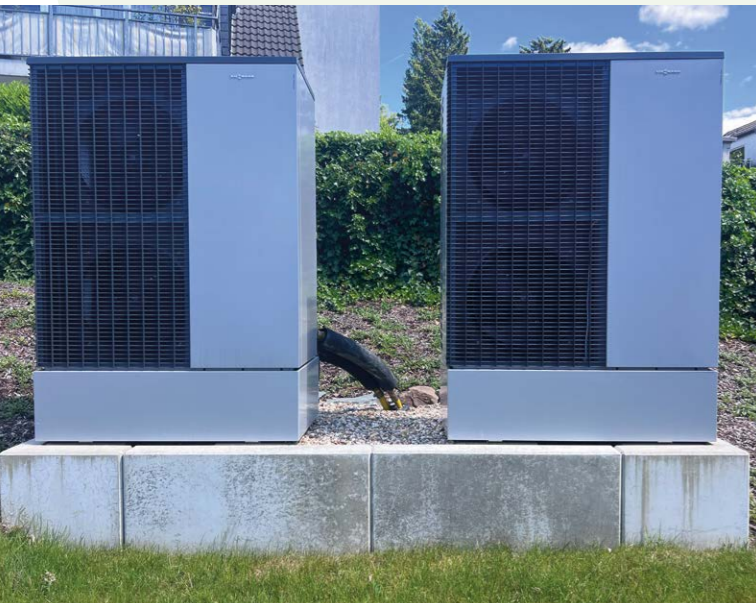
Wärmepumpenanlage Neubau Etzelstraße
